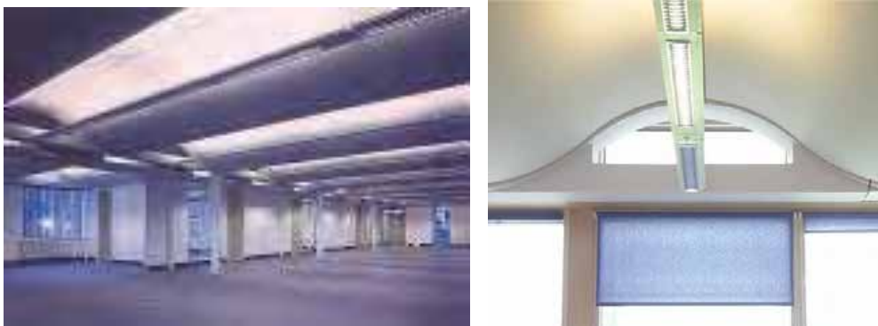
شكل ( ٣-٥٠): شكل يوضح استخدام المبنى وحدات اضاءة موفرة للطاقة (المصدر: Michael Wigginton and Jude Harris, "Intelligent Skins")
