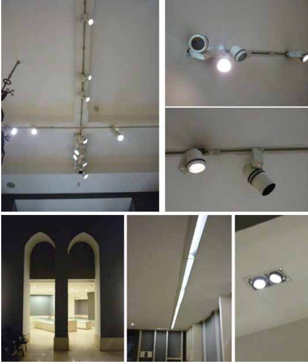
شكل ( ٣-٨٩): مجموعة من أشكال وأنواع وحدات الأضاءة المستخدمة في أنارة المبنى (المصدر: الباحث)
