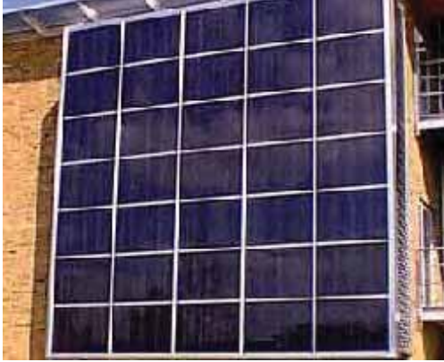
شكل ( 3-59): الخلايا الفولتية الضوئية (PV) التي تكسو الحائط المواجه للواجهة الجنوبية (المصدر):
